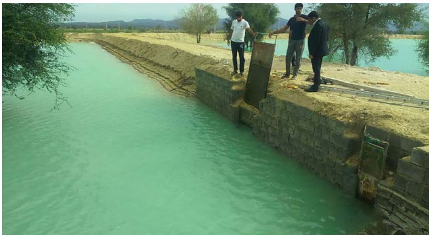
شکل ۱۲: نمایی از بند آب ذخیره سیلاب و دریچه‌های کنترل تعبیه شده در بین بندها
