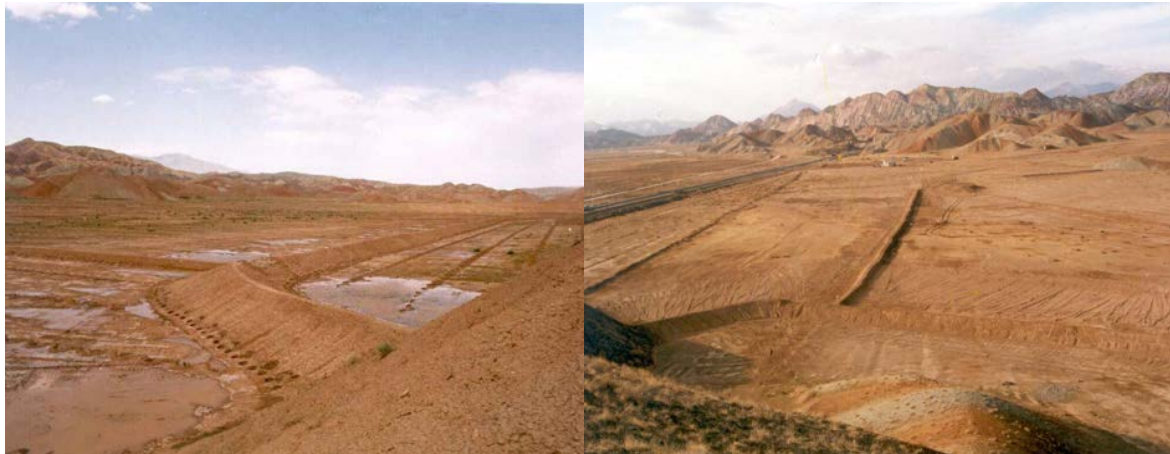
شکل ۴: تصاویری از کنتورباندهای احداث شده در ایستگاه تحقیقات حفاظت خاک و آبخیزداری خواجه (سال ۱۳۷۳-۱۳۷۵)
