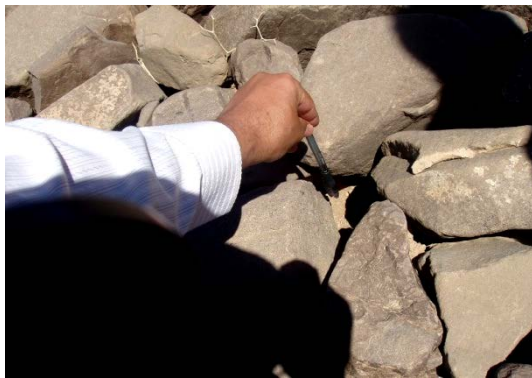
شکل ۱۲: چیدن یک لایه سنگ روی خاک ریزدانه (اجرای غلط ریپ‌رپ)
