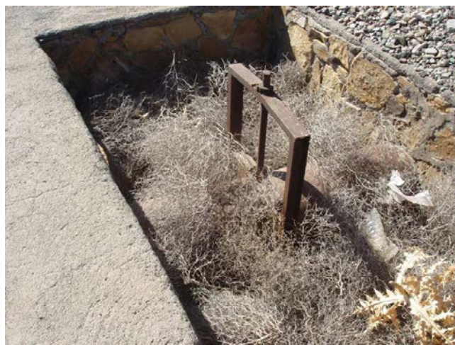
شکل ۱۳: وضعیت نمونه‌ای از شیرهای تخلیه تحتانی بلااستفاده در پروژه‌ها
