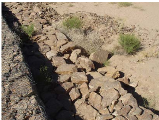
شکل ۱۰: نمونه‌ای از اجرای نامناسب ریپرپ که توان حفاظتی کافی را ندارد
